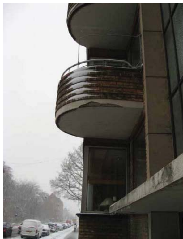
Hobrovej 50 - opført 1939 Vandrette bånd i røde tegl, fordakning over den helrudedede dør og gennemgående trappevindue.
