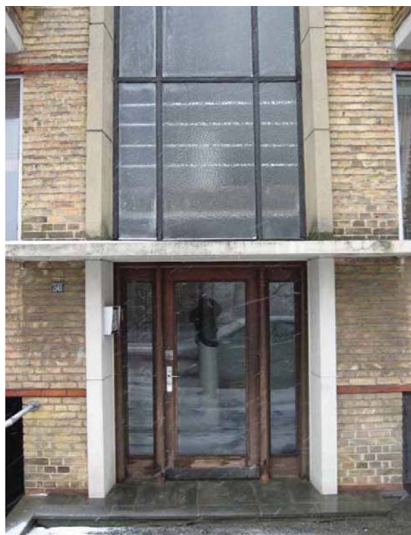
Hobrovej 50 - opført 1939 Vandrette bånd i røde tegl, fordakning over den helrudedede dør og gennemgående trappevindue.
