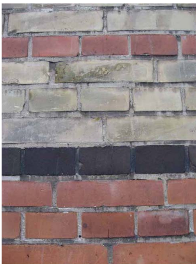
Hobrovej 38 Detalje af murværk. Bemærk de sorte studsfulger i indfarvet mørtel i de sorte sten.
