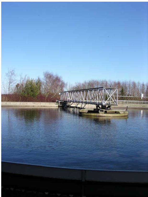
Klaringstank på Langå Rensningsanlæg.
