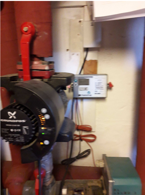
Alt varme og varmtvand bliver målt på en central måler
