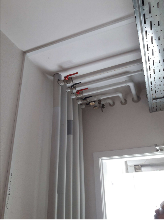
Bliver fordelt på hver etage i teknikrummene sammen med vandet
